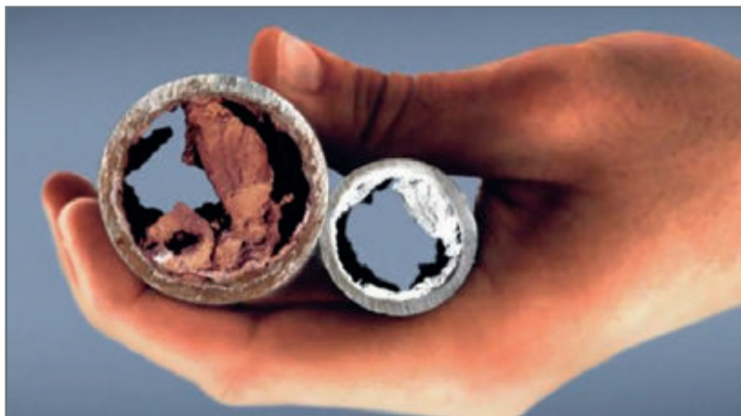
Отложения в трубах ухудшают работу системы водоснабжения на животноводческих фермах
